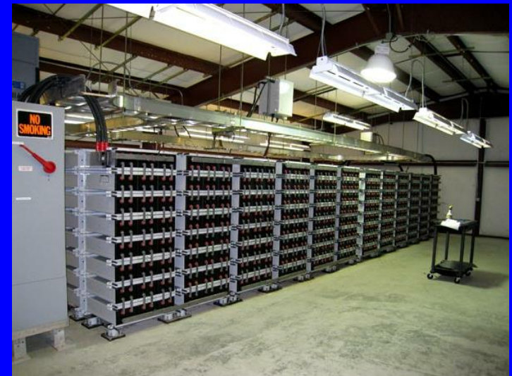
1MW / 1.4MWh Feb. 1997
