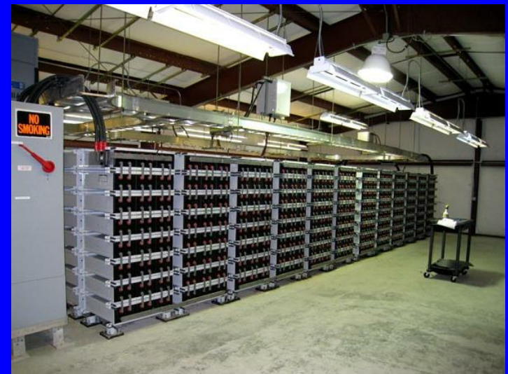
1MW / 1.4MWh Feb. 1997
