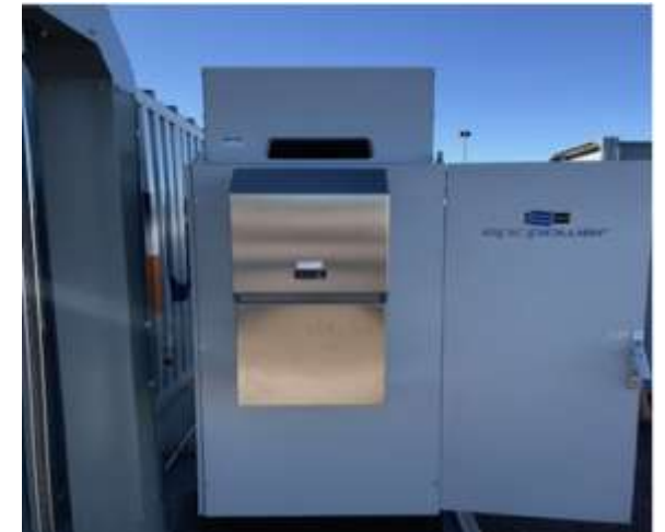
EPC inverter at NELHA
